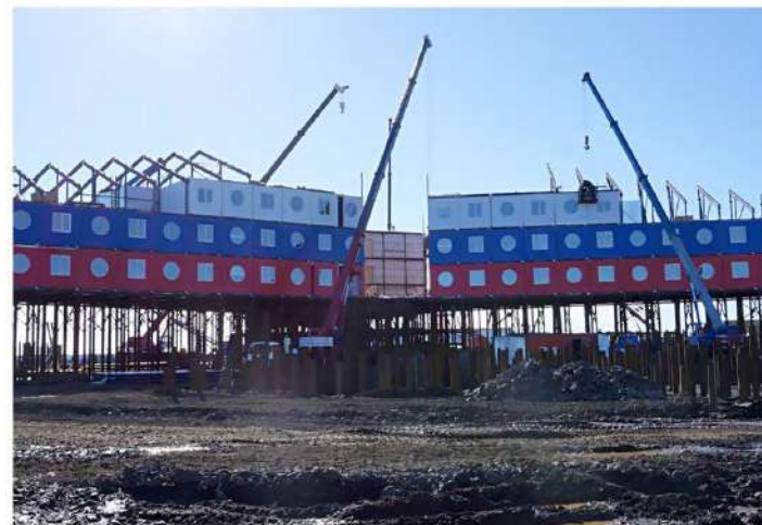
Рис. 12. Монтаж здания из объемных блоков заводской готовности с опиранием на стальной каркас (Источник: https://aftershock.news/?q=node/378186 )
