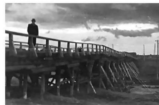
Рис. 13. Б. И. Далматов при обследовании деформированного моста в г. Игарке
